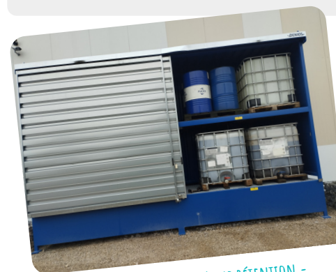
CONTAINER ÉQUIPÉ D'UNE RÉTENTION - SUBVENTION DE 70% PAR L'AGENCE DE L'EAU
